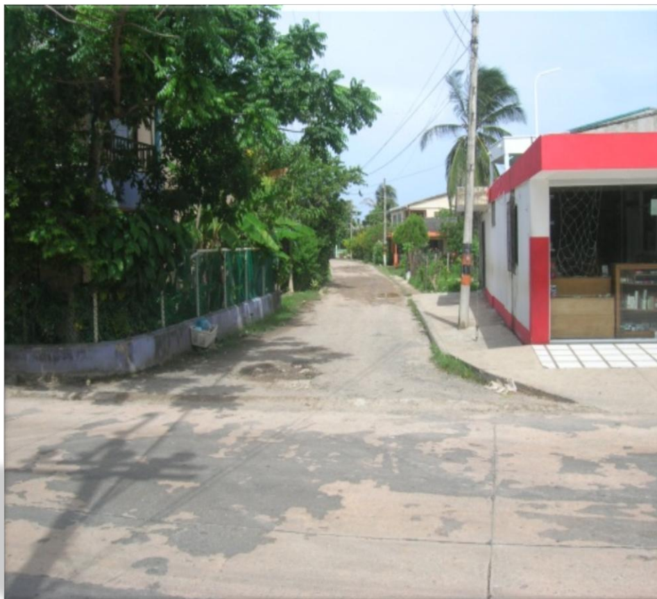
ESTADO ANTERIOR VIA ACCESO TIENDA
