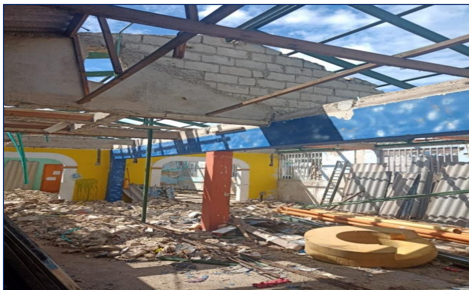
Foto 3. Mantenimiento de la Ludoteca Naves Chills. Fuente: Secretaria de Educación Departamental. Fecha: Diciembre del 2022
