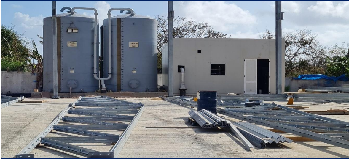
Imagen. Finalizó instalación de tanque de almacenamiento y caseta de bombeo de la línea de impulsión.
